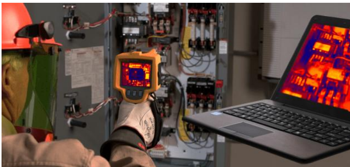
Рисунок 20. Пример проведения тепловизионного контроля электрошкафа
