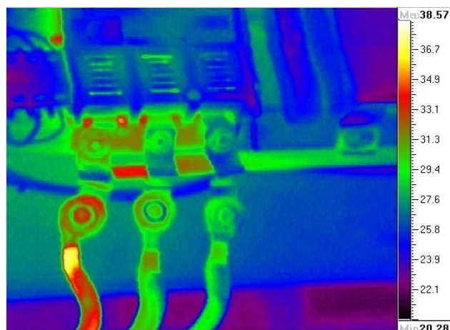
Рисунок 21. Пример термограммы контактных соединений с температурной шкалой
