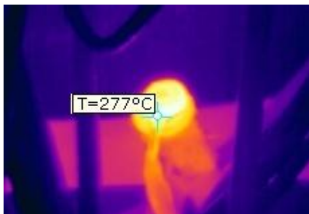
Рисунок 22. Пример обнаружения пожароопасного разогрева болтового контактного соединения
